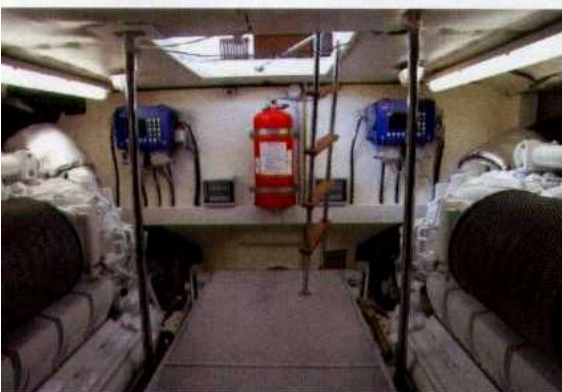
La sala motori è razionalmente studiata per favorire qualsiasi intervento.
